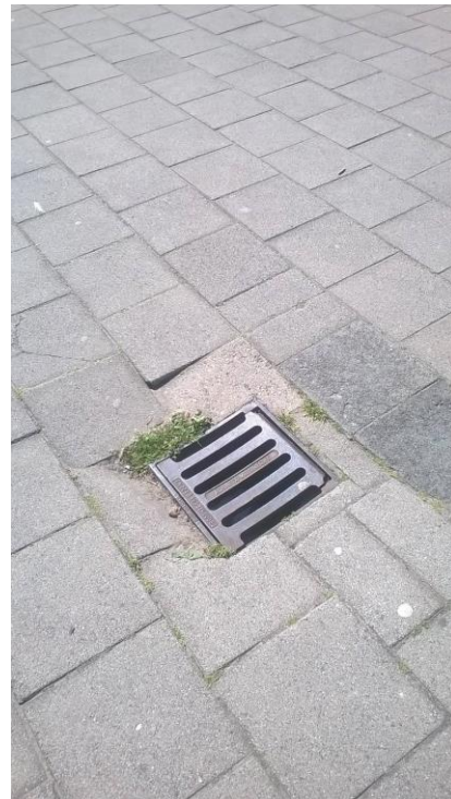
Foto 12: verzakte put (struikelgevaar).
