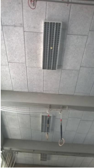
Foto 6: niet afgeschermdde armaturen.
