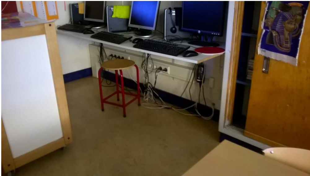
Foto 1: Losliggende kabels en snoeren.
