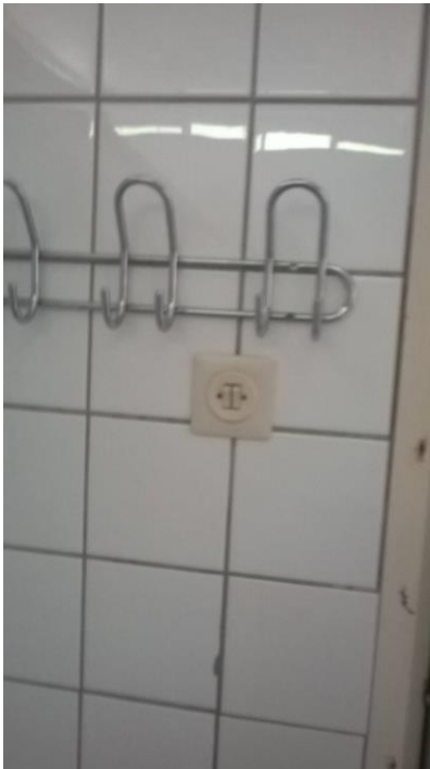
Foto 8: schakeldoos in douche (natte ruimte).
